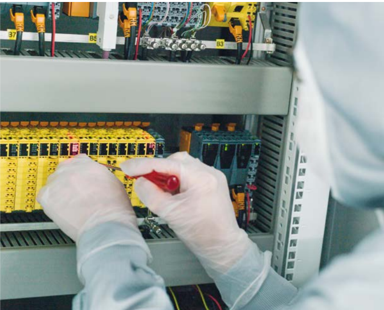
Die Automatisierungslösung ist in 6 einzelne Systembereiche aufgeteilt, so konnten die Komponenten optimal platziert und die Kabelanzahl reduziert werden.
